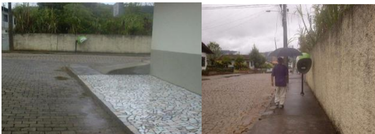
Foto 14 - Presença de desníveis e obstáculos nas calçadas
